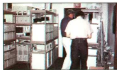
Ein Traum für Technik-Fans: der Netzwerkraum
